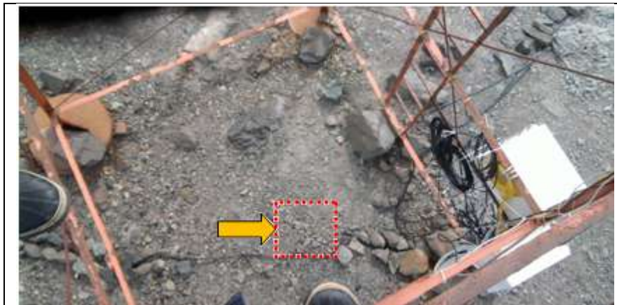
Figura 9. Local de instalação dos sensores de temperatura e fluxo de calor no solo.
